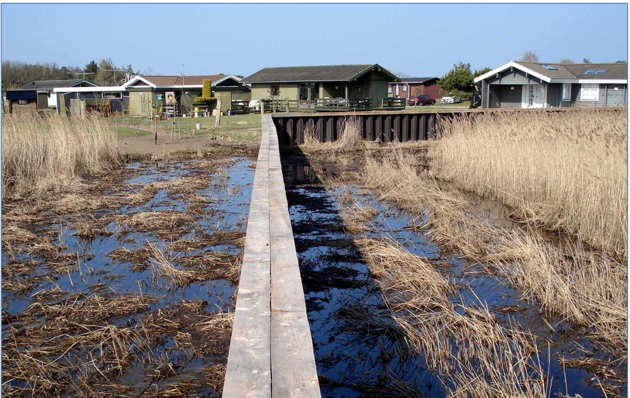
Bogensø, april 2009: En mange hundrede meter lang spunsvæg blev i 2009 opført ud gennem det fredede område ved Bogensø.
