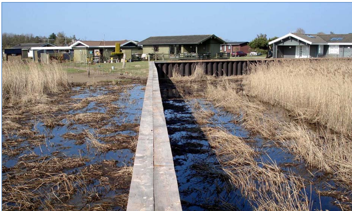
Bogensø, april 2009: En mange hundrede meter lang spunsvej blev i 2009 opført ud gennem det fredede område ved Bogensø.
